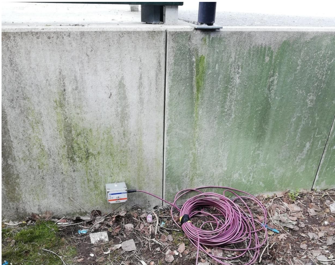
Figur 4 Givaren i MP1 monterad i busshållplatsens fundament.
